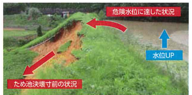
付近一帯に「避難指示」が発令された滝宮の奥池(平成30年7月 西日本豪雨)
